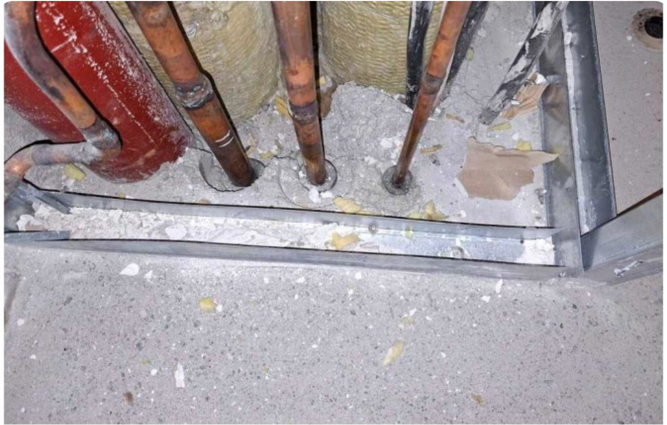
Kuva 2 Huoneisto B 27. Kylpyhuone. Vesijohtojen eristeenä läpivienneissä on solukumieriste.
