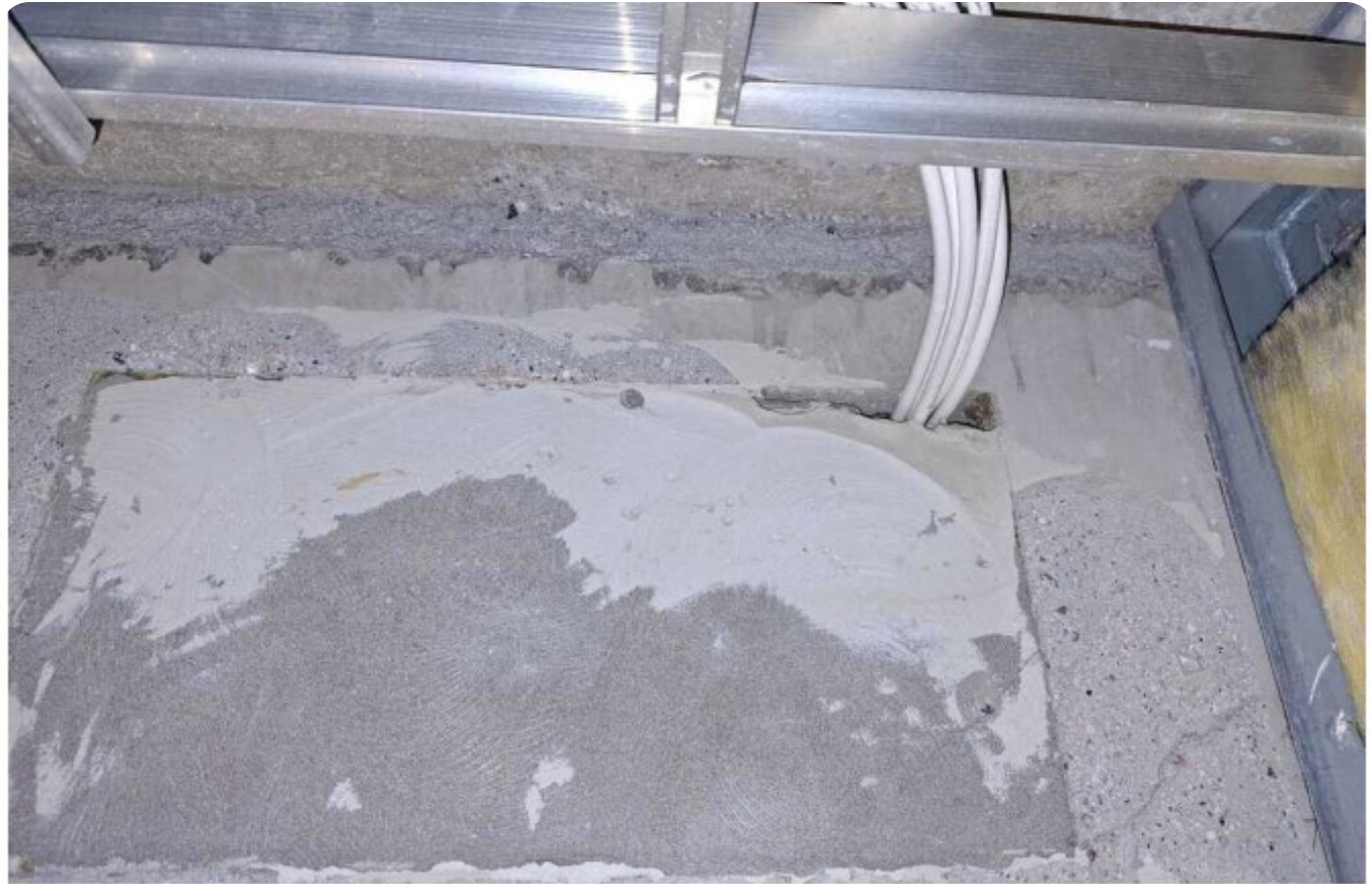
Kuva 10 Huoneisto B 19. Kylpyhuone. Sähkökaapeleiden läpiviennissä porrashuoneeseen ei havaittavissa palokatkoa.
